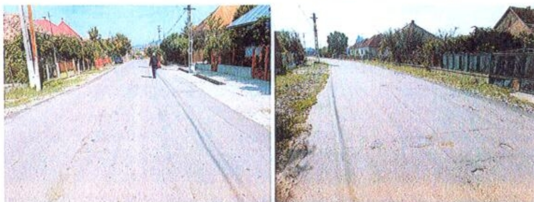
Fig. 6 Degradări suprafață de rulare asfaltică
